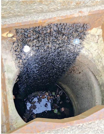
Montierte Ausstiegshilfe an der Büelstrasse (Abt. Tiefbau u. Umwelt, 2026)
