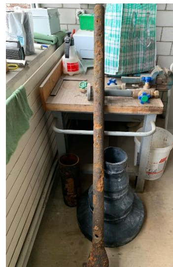
Abbildung 5: Durch Korrosion beschädigte Leitung im Junker
